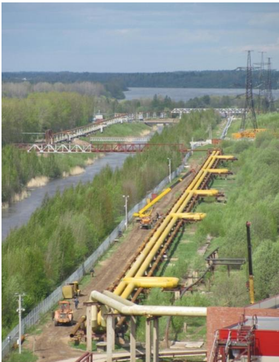
Рисунок 16 - Внешний вид газопроводов
